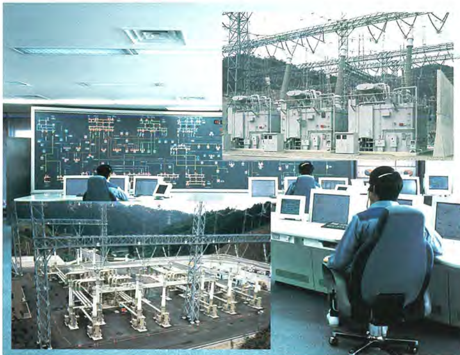
図1. 系統制御システム及び500kV変電機器
