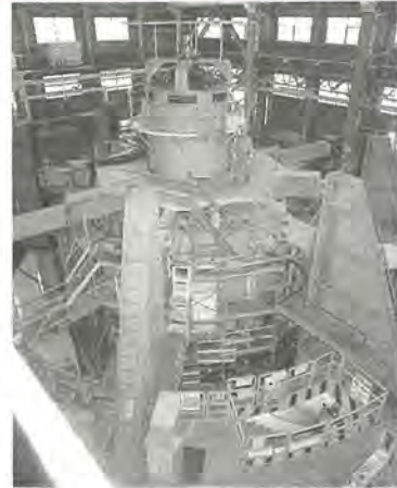
279MVA/271MW発電電動機
