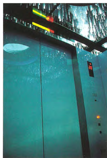
エレベーターのかご室内部
