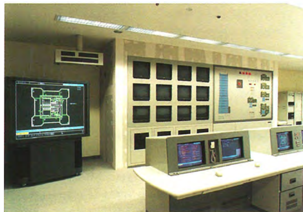
防災センター
