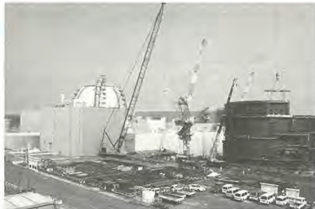
九州電力(株)玄海原子力発電所3、4号機
