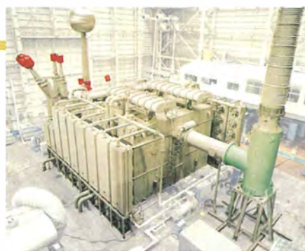
1,050/√3 kV 3,000/3MVA変圧器の外観
