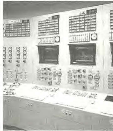
九州電力(株)新大分発電所 2号機中央制御盤
