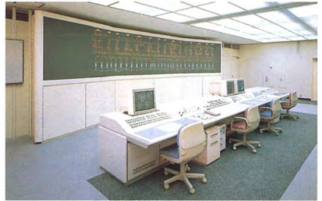
電気司令所の司令室全景
