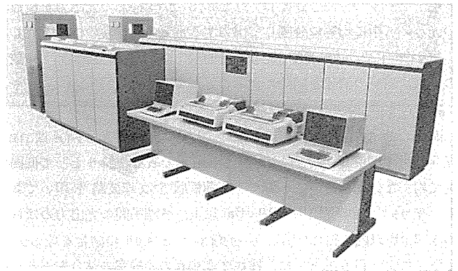
中部電力(株)中央通信所納めパケット多重化装置 (CMX)
