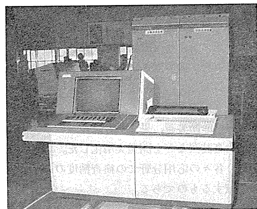
非常用発電装置の自動点検装置
