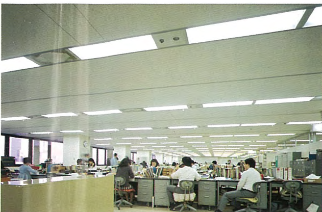
2. 秀和芝パークビル（東京都） 蛍光灯位置を深くしてランプの直視を少なく、まぶしさを軽減した埋込み下面開放形システム天井用器具を使用して快適な作業環境をつくっている。省電力形蛍光灯ランプ、安定器使用。
