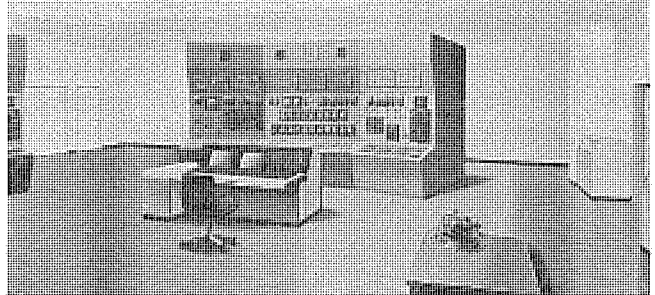
火力発電所中央制御室
