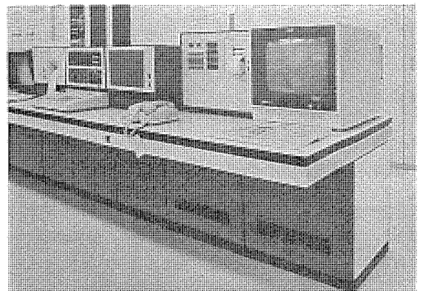
サブセンターオペレータコンソール
