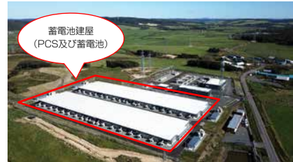
システム全景(千代田化工建設㈱提供)
