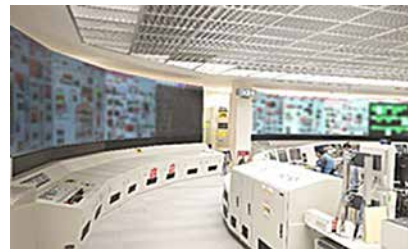
デジタル型中央制御盤
