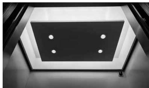
天井照明(取替え後)
