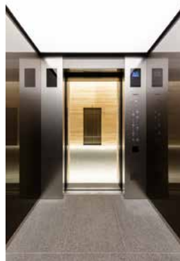
オフィス用エレベーター かご内
