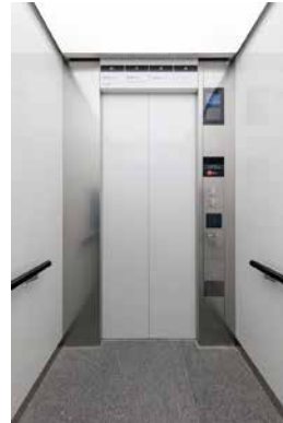
商業用エレベーター かご内
