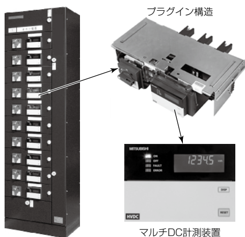
図7. マルチDC計測装置搭載の直流給電用分電盤
