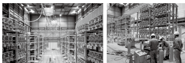
(a) HVDCバルブホールの全景 (b) HVDCの検証状況
