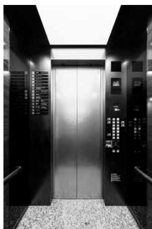
図9. オフィス用エレベーターのかご室
