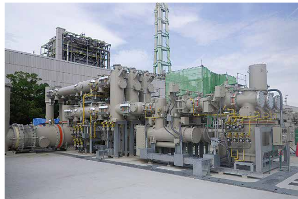
300kV GIS 現地据付状況(2020年8月撮影)
