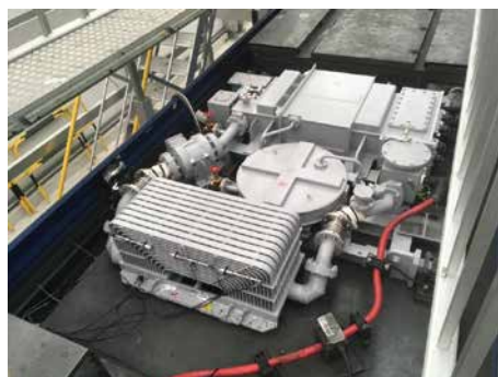
屋根上配置走行風利用自冷式主変圧器
