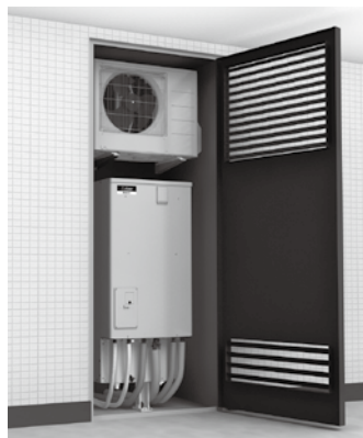
メータボックス内設置例
