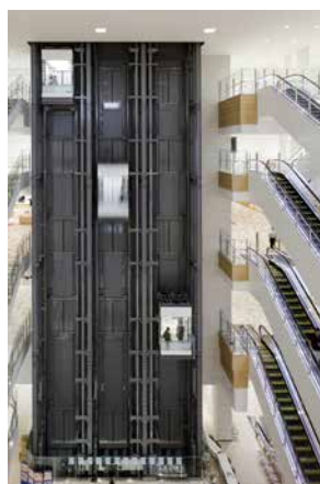
吹き抜け空間のエレベーター
