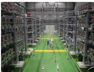
図1. 検証棟内のHVDCダイヤモンド(バルブホール)
