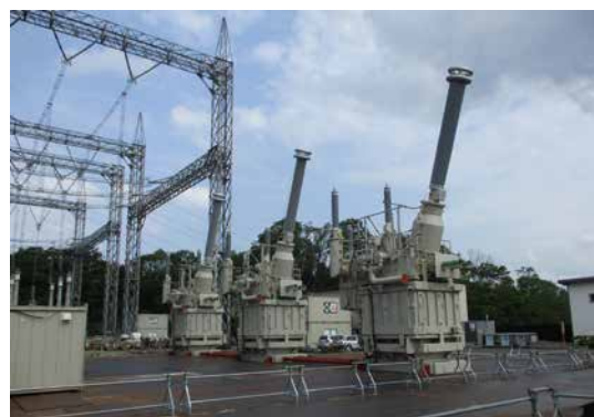
別位置組立て完了後に構内仮置き中の新形変圧器
