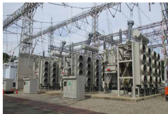
現地据付け・調整試験完了後の新形変圧器
