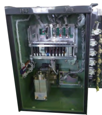
ブレーキ制御装置
