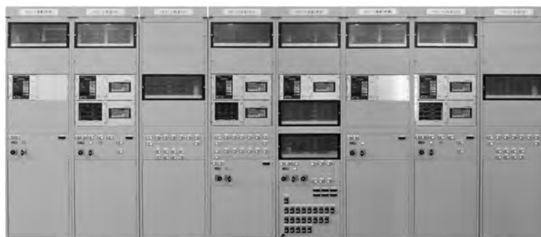
西部方面統合型系統安定化システムの子局装置
