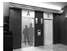
エレベーターシステム
