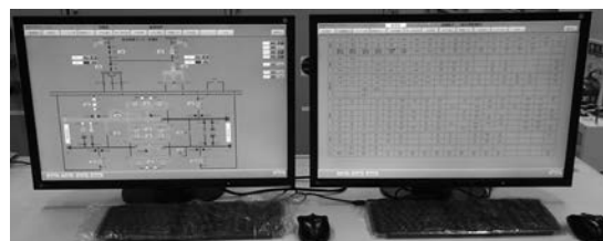
図7. 監視制御卓の外観
