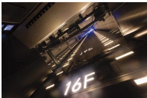
図1. 展望台行きシャトルエレベーターから見た昇降路
