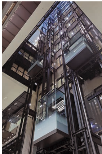
図2. 百貨店用センターエレベーター
