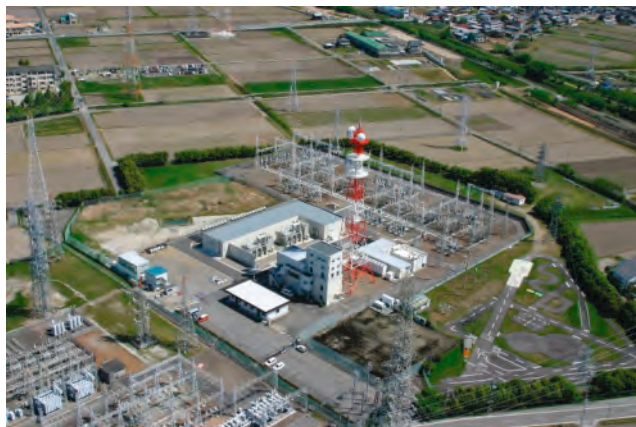
関西電力(株)犬山開閉所納めのSTATCOM
