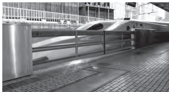
東海道新幹線向けパイプフレーム可動柵(東京駅)
