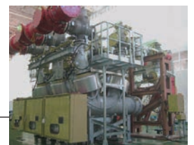
図4. 245kV / 80kA GIS
