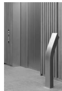
図4. シャトルエレベーター乗り場
