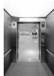
図18. エレベーターかご室
