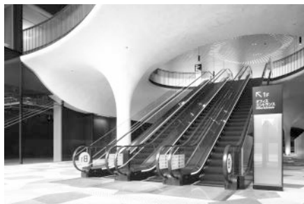
図3. エスカレーター
