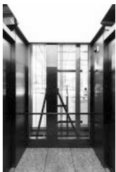
図11. 低層階用エレベーター
