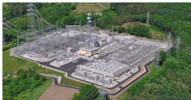
中部電力(株)東信変電所納めSTATCOM
