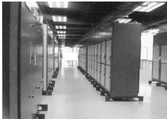
図2. デジタル計装制御設備
