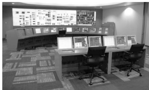
図2. 中央計装システムの運転検証設備
