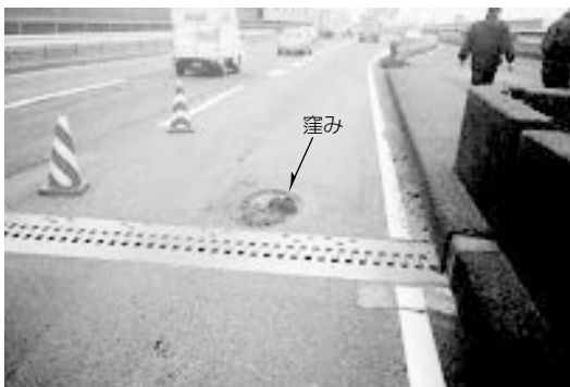
図1. 路面に発生した窪み
