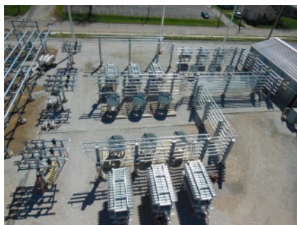
図1. 米国AEP電力会社の変電所
