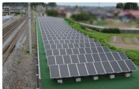
図1. 平泉駅東側に設置した太陽光発電
