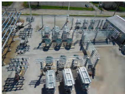
図1. 米国AEP電力会社の変電所
