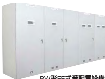
PW形FF式受配電設備
