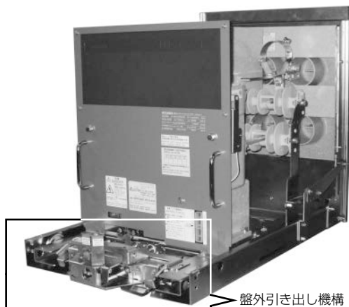
図5. 真空コンタクタ(盤外引き出し機構)
