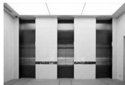
図5. オフィス用エレベーター乗り場
