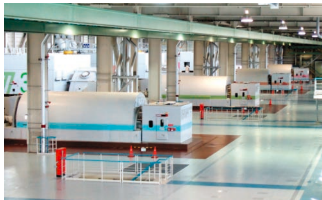
堺港発電所のコンバインドサイクル発電設備
