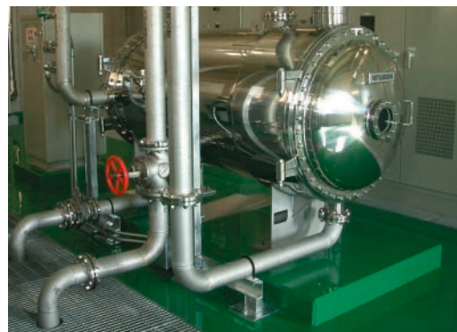
東村山浄水場向けオゾン発生装置
