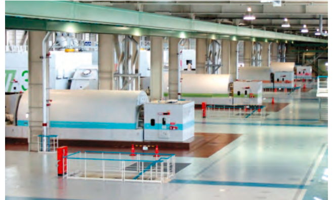
堺港発電所のコンバインドサイクル発電設備
