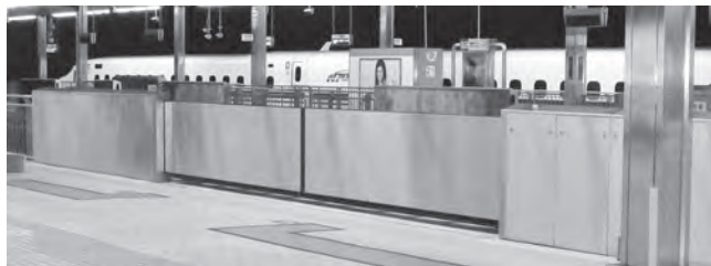
大開口可動式ホーム柵(新横浜駅、開口幅6.8m)
