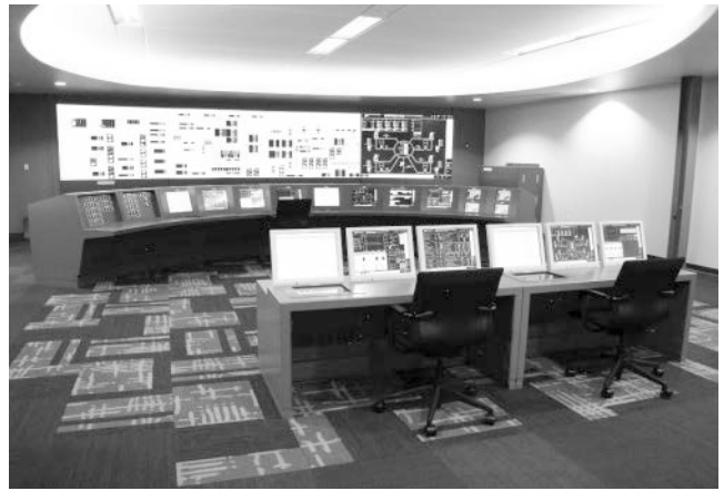
図3. 米国向け中央計装運転検証設備
