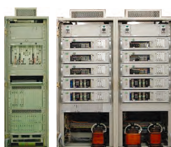
制御棒制御装置 (左:ロジックキャビネット 右:パワーキャビネット)
