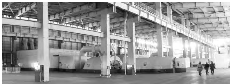
川崎火力発電所1号系列タービン・発電機
