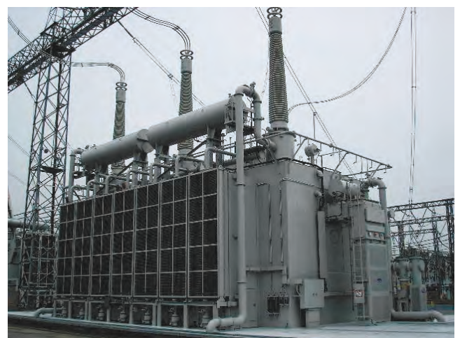
東京電力(株)納め新富士変電所5号主要変圧器 (750MVA, 512.5/147/63kV)
