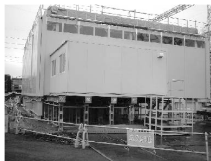
図7. 500kV級変圧器の現地組立てハウスの外観を示す。
