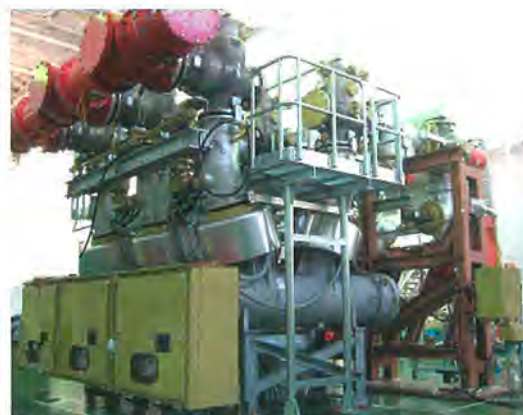
245kV 80kA GIS
