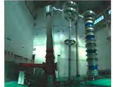
耐電圧試験装置
