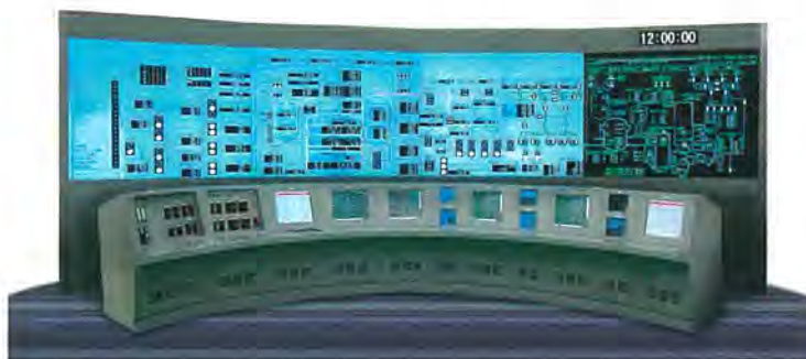
新型中央制御盤の外観
