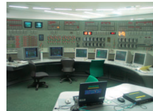
舞鶴発電所第1号機中央操作室
