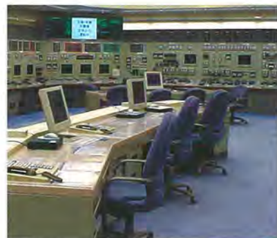
更新後の中央制御室
