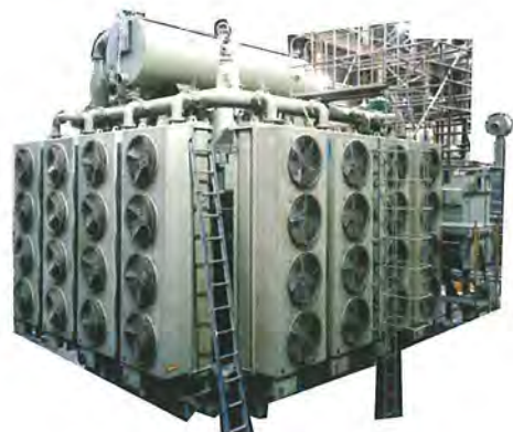
1号機主要変圧器
