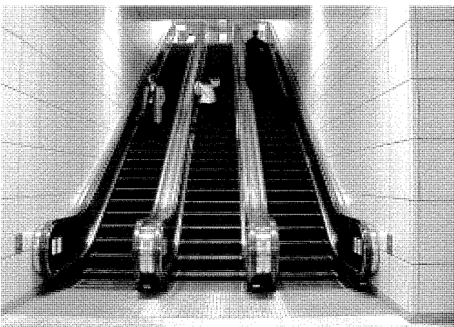
東日本旅客鉄道(株)舞浜駅納入 3台並列設置省スペース形エスカレーター
