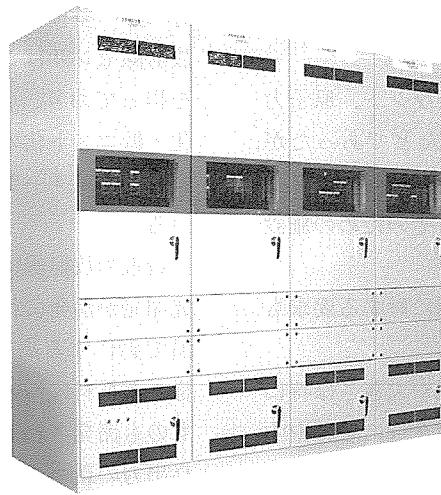
図2. 放射線監視盤の外観
