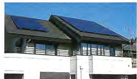
図5. 住宅に設置した太陽光発電システム
