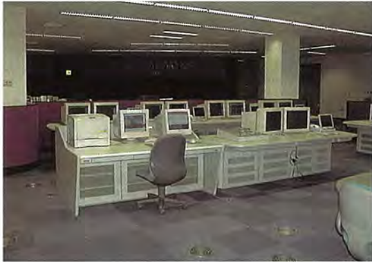
電力遠制システムの指令室
