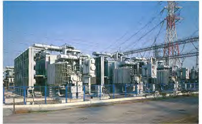
525/275/63kV 1,000/1,000/500MVA 三次容量増大单相单巻変圧器の外観
